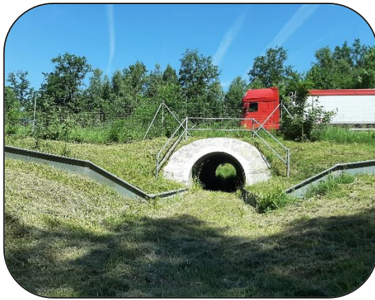
Querungstunnel für Tiere unter Bergareuterstraße im Altendorfer Wald (Quelle: HHP 2021)
